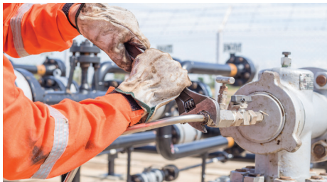
Bei der Wartung von Pumpen, Ventilen, und Generatoren vor Ort
